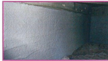
アンカーボルトの部分にも無補強部位の様な損傷は無い。
