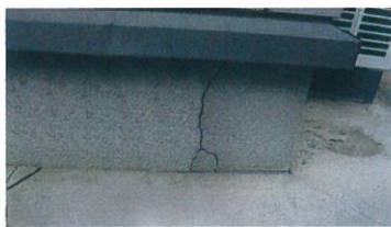
アンカーボルト付近の基礎にひび割れが発生。
