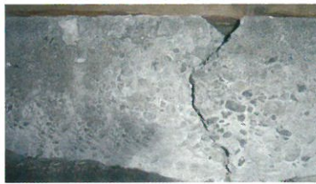
アンカーボルトが原因と思われる基礎の亀裂。
